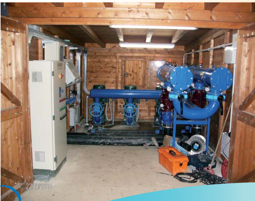
INTERNO DELLA STAZIONE DI POMPAGGIO
